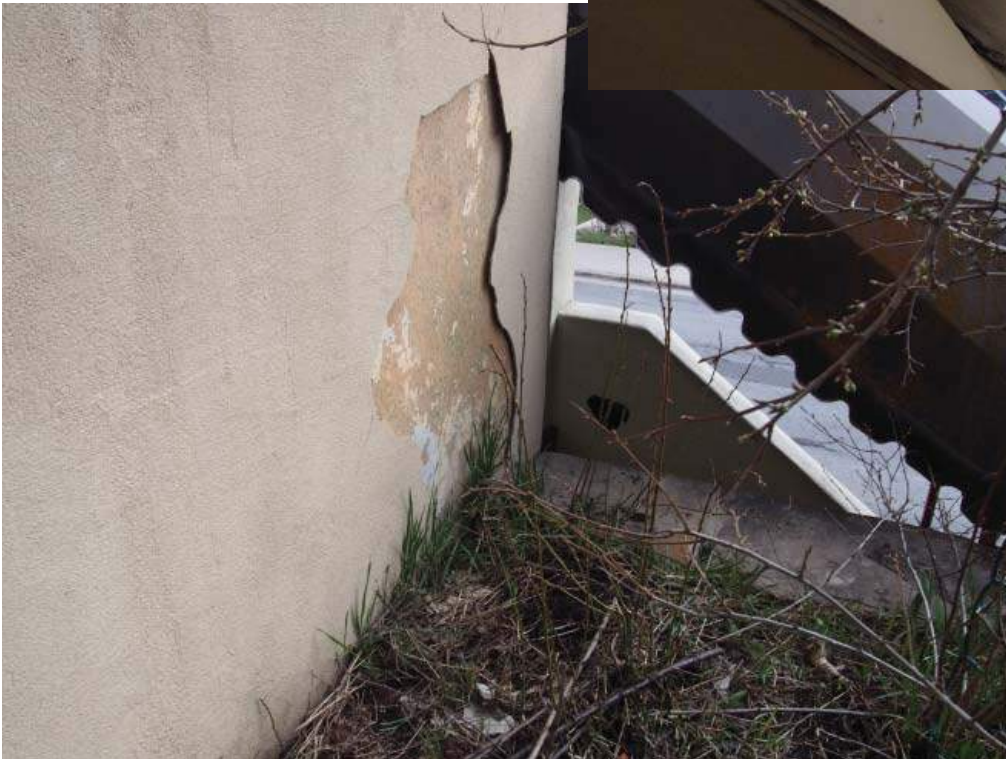
33 - SE Wall Stucco Peel
